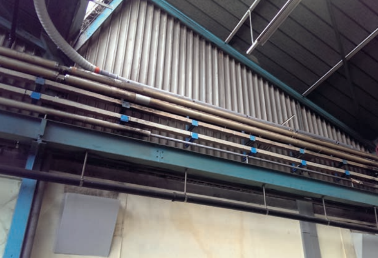
MS-Kabeltrasse in luftiger Höhe
