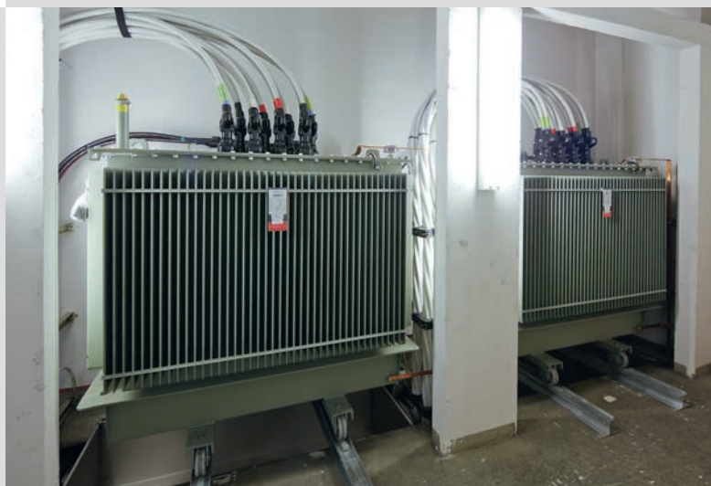
Leistungssteigerung und erhöhte Verfügbarkeit durch neue Transformatoren in Ringschaltung
