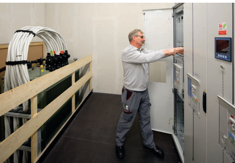
TS 4 in Holzbauweise, ausgestattet mit einer SF 6 -freien MS-Anlage Typ Xiria-E von Eaton
